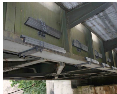
Absorbeur sur platelage
